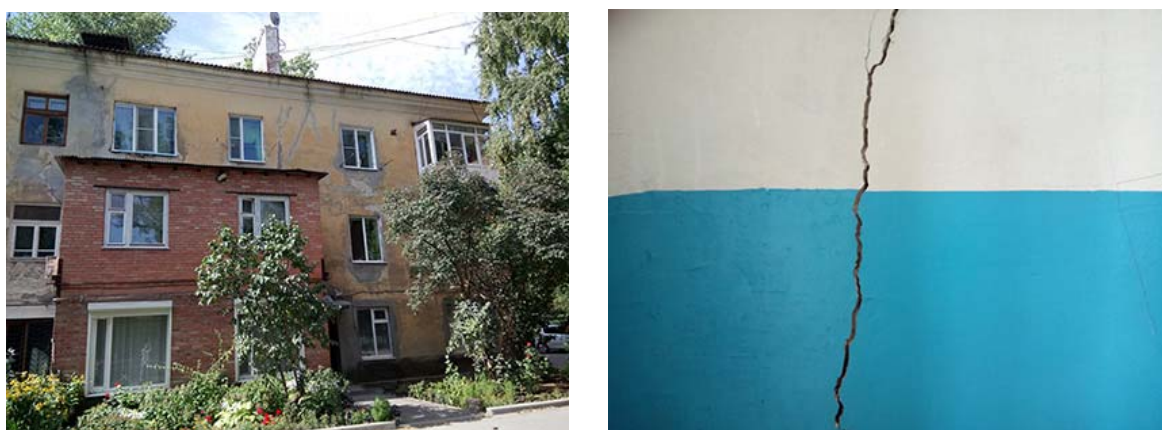
Рис. 1. Дефекты ограждающих конструкций в жилых зданиях
