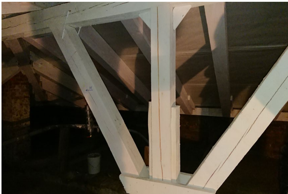
Рис. 1 – Трещины усушки раскрытием до 10 мм
