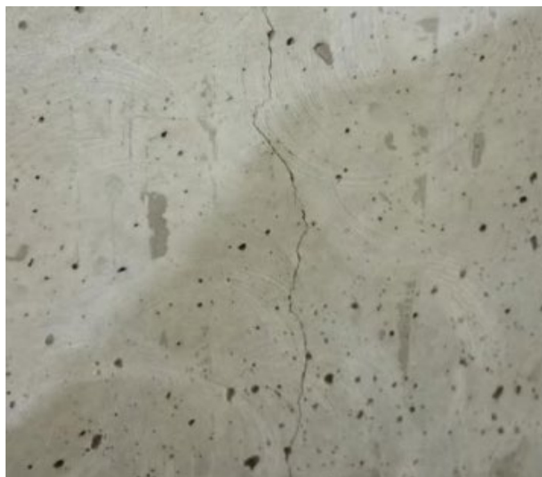
Рис. 1. – Трещина в теле железобетонной конструкции
