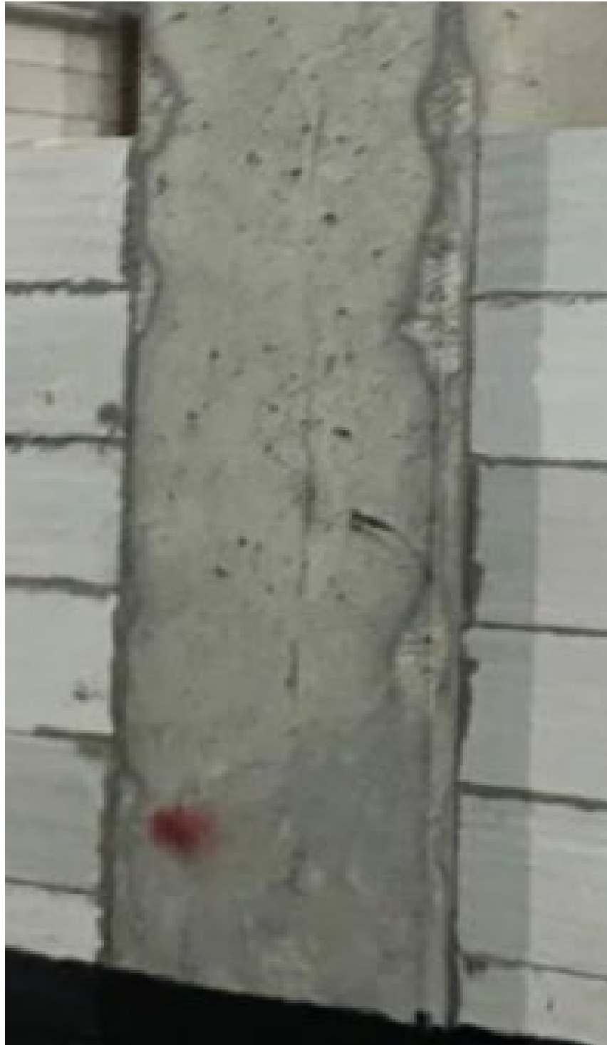
Рис. 7. – Щербенистость бетона железобетонной колонны
