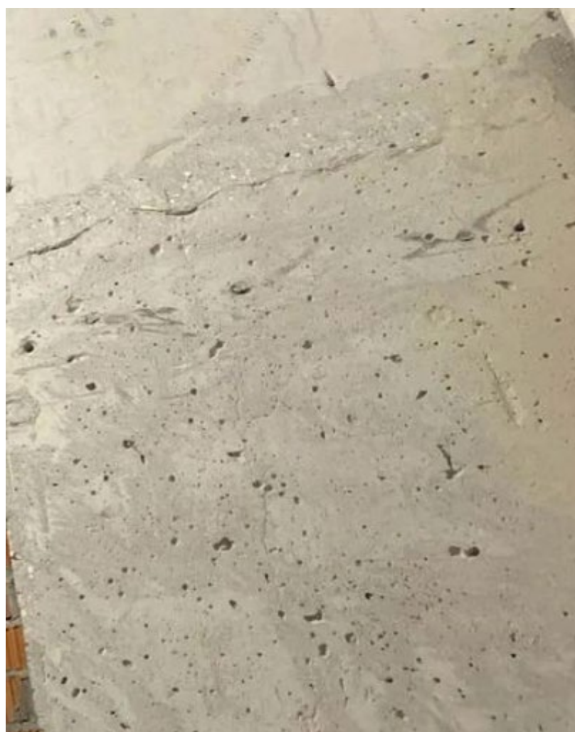
Рис. 5. – Раковины на поверхности железобетонной конструкции
