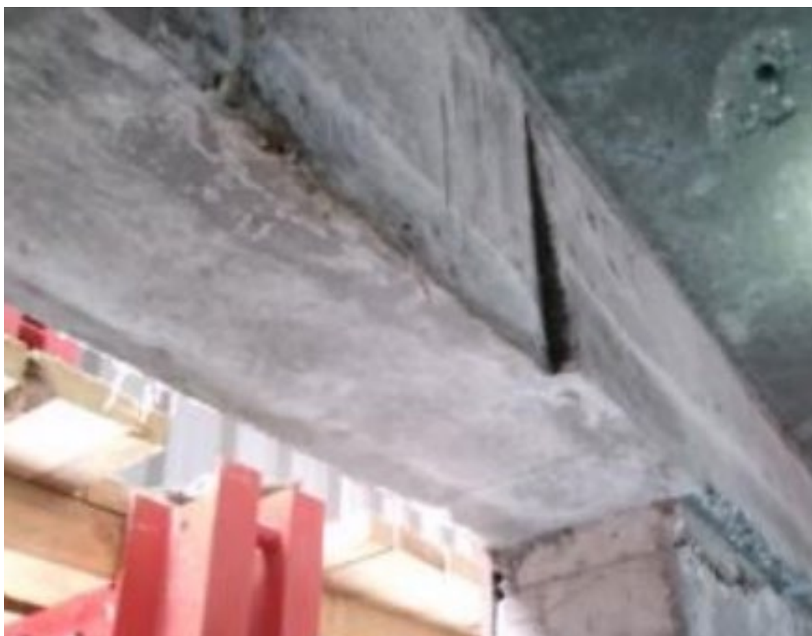
Рис. 8. – Нарушение геометрии железобетонной конструкции
