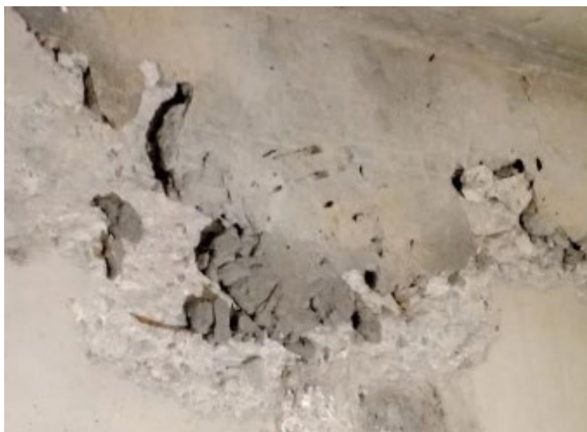
Рис. 6. – Наплывы бетона на поверхности железобетонных конструкций
