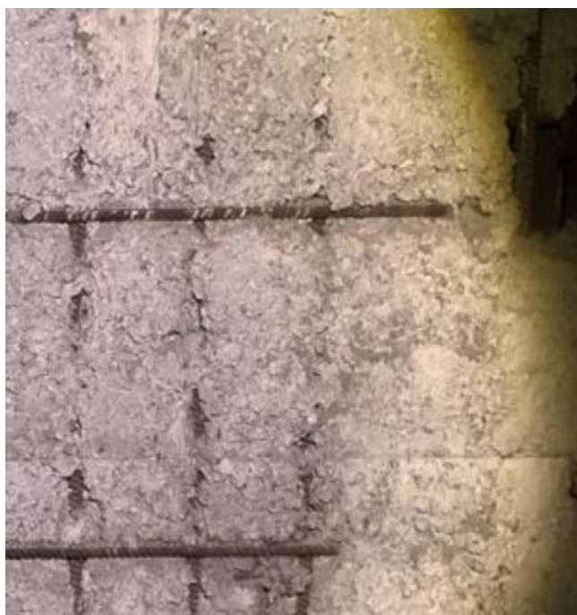
Рис. 3. – Разрушение защитного слоя бетона
