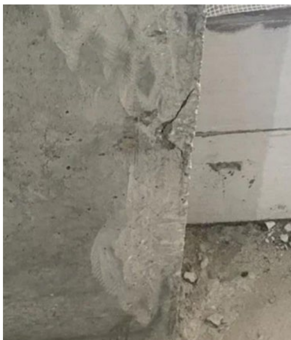
Рис. 2. – Скол бетона железобетонной конструкции
