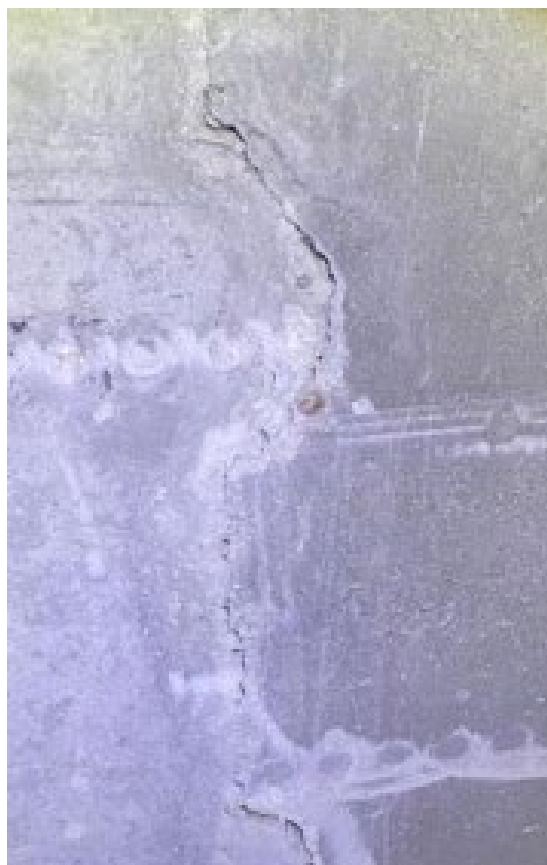
Рис. 9. – Холодный шов бетонирования
