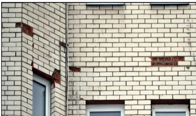
Отслоение слоя пониженной паропроницаемости
