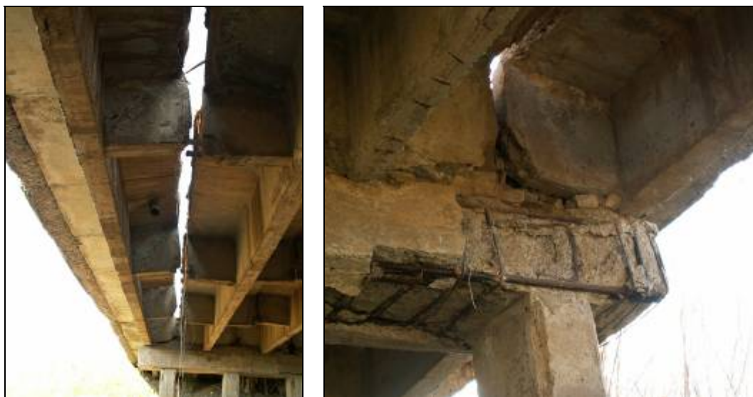
Рис. 1. Аварийное состояние моста через Верхне-Сальский канал на ПК 242+50 в Зимовниковском районе вблизи х. Иловайский
